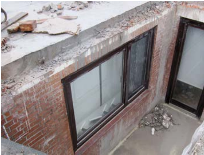
Abb. 8: Betonieren der Ringanker. Der Spalt zwischen Klinker und Hintermauerwerk wurde nicht geschützt. Erster Wasserschaden für den Bestand.
