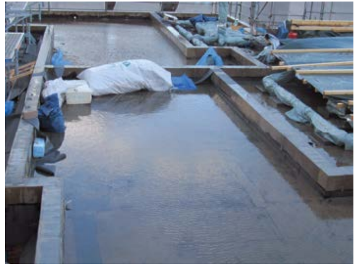
Abb. 9: Durch Regen stand Wasser zwischen den neu gegossenen Ringankern auf der alten Bestandsdecke. (siehe Abb. 7) Der nächste Schaden war vorprogrammiert.
