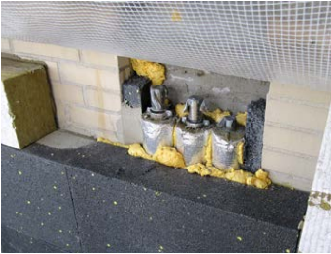
Abb. 6: Die Trinkwasserleitungen mussten in die bestehende Wand eingefräst werden, da sie nicht in den alten Schächten untergebracht werden konnten. Dies wurde von den vorbefeassten Architekten und Fachplanern, wie auch dem Holzbaubetrieb nicht bedacht.
